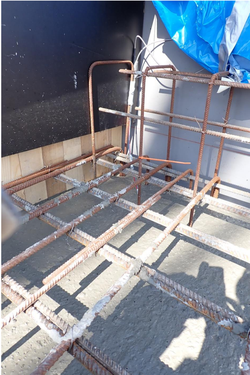
Figur 36: Ej lämpligt att ha sensorerna fria i vertikalled. Det blir stora belastningar vid gjutning. Sensorerna måste fixeras mot t.ex. armeringsjärn.
